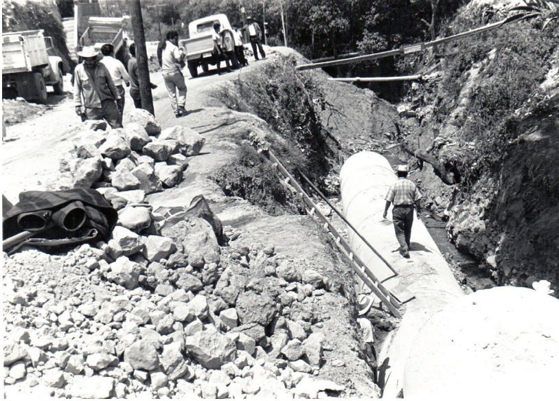
IMAGEN 3. Red de drenaje y alcantarillado de barranca de avenida Nuevo León, hoy avenida Castorena, construida en los años 1968 y 1969, por el delegado del departamento central del Distrito Federal en Cuajimalpa, licenciado Mario Ruiz Moreno, en su periodo de gobierno 1964-1970, con tubo de 2.70 metros de largo por 1.53 metros de diámetro. Fue supervisada por don Venancio Segura Carrillo, secretario de obras de la delegación, quien aparece arriba del tubo. Acervo personal de José César Muciño Pérez.
