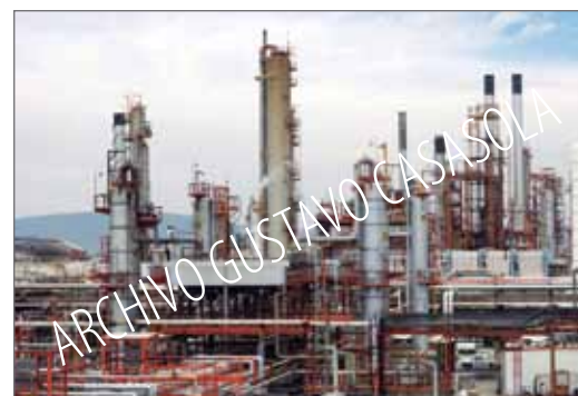
La refinería de Salamanca en el estado de Guanajuato, inaugurada durante la presidencia del Lic. Miguel Alemán en los años cincuenta, se ha mantenido hasta el siglo XXI como una de las unidades de producción petroquímica más importantes. Foto: Pemex.
