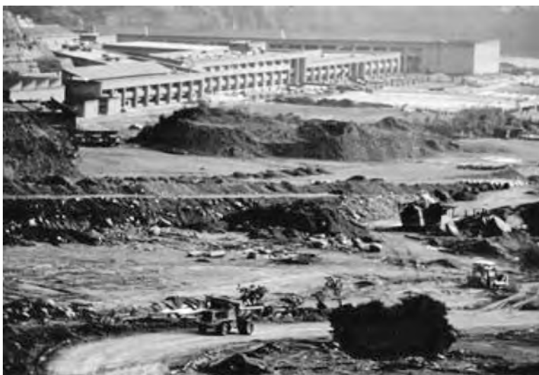
Fotografía 1. La Universidad Iberoamericana y áreas circundantes en construcción en 1985 (fotografía cortesía de Servimet).
